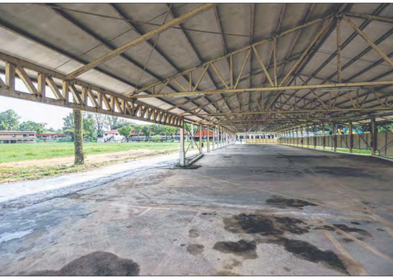
旧训练舍的桁架、横梁和支柱将被保存，日后设法融入新组屋区的设计中。（关俊威摄）
